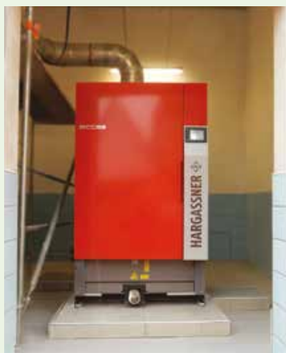
Peletkový kotel, kotelna Barviřská 10, Třešť
