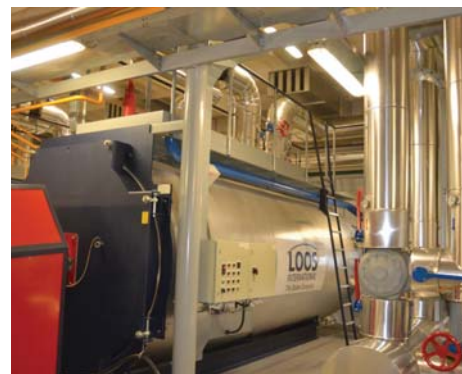
Kotelna K4 - kotel LOOS
